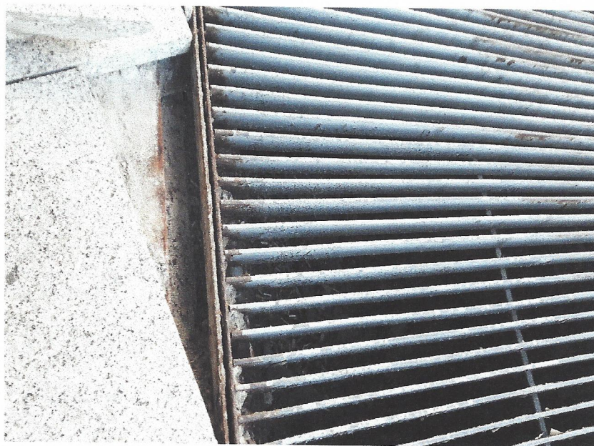
Fot.3,4. Styk okładziny kamiennej z kratami pomostowymi.
