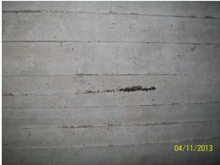
Fot.10. Widoczne na powierzchni stropu fragmenty prętów zbrojeniowych.
