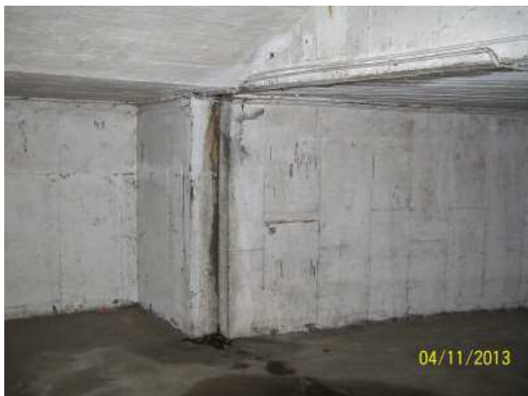
Fot.12. Widok dylatacji bocznej od strony czerpni.
