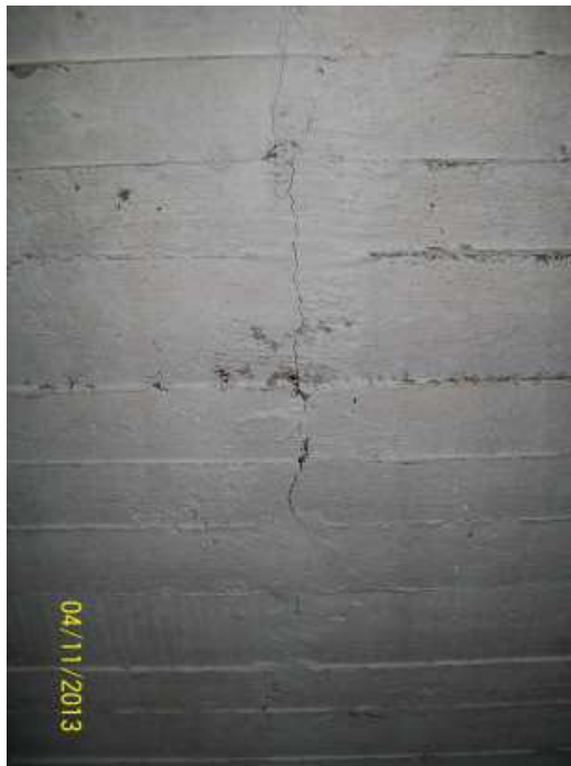
Fot.9. Mikrorysy na powierzchni stropu pomieszczenia czerpni.
