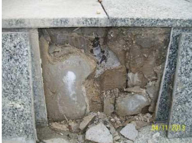
Fot.4. Odspojona o podłoża pionowa płyta okładziny granitowej.
