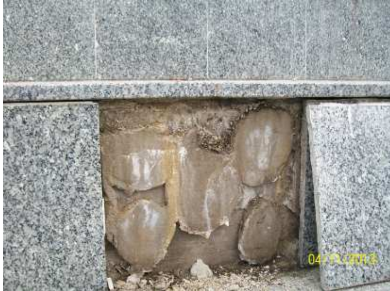
Fot.3. Odspojona o podłoża pionowa płyta okładziny granitowej.
