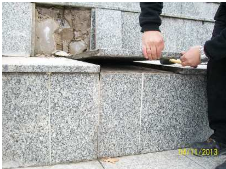
Fot.5. Luźna okładzina pozioma.
