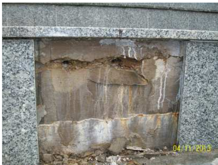
Fot.7. Zniszczenie otuliny betonu.
